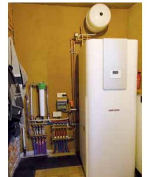
Het gecombineerd boiler- en buffervat, dat bewust op slechts enkele meters afstand van de buitenunit is geplaatst om warmte te conserveren.
